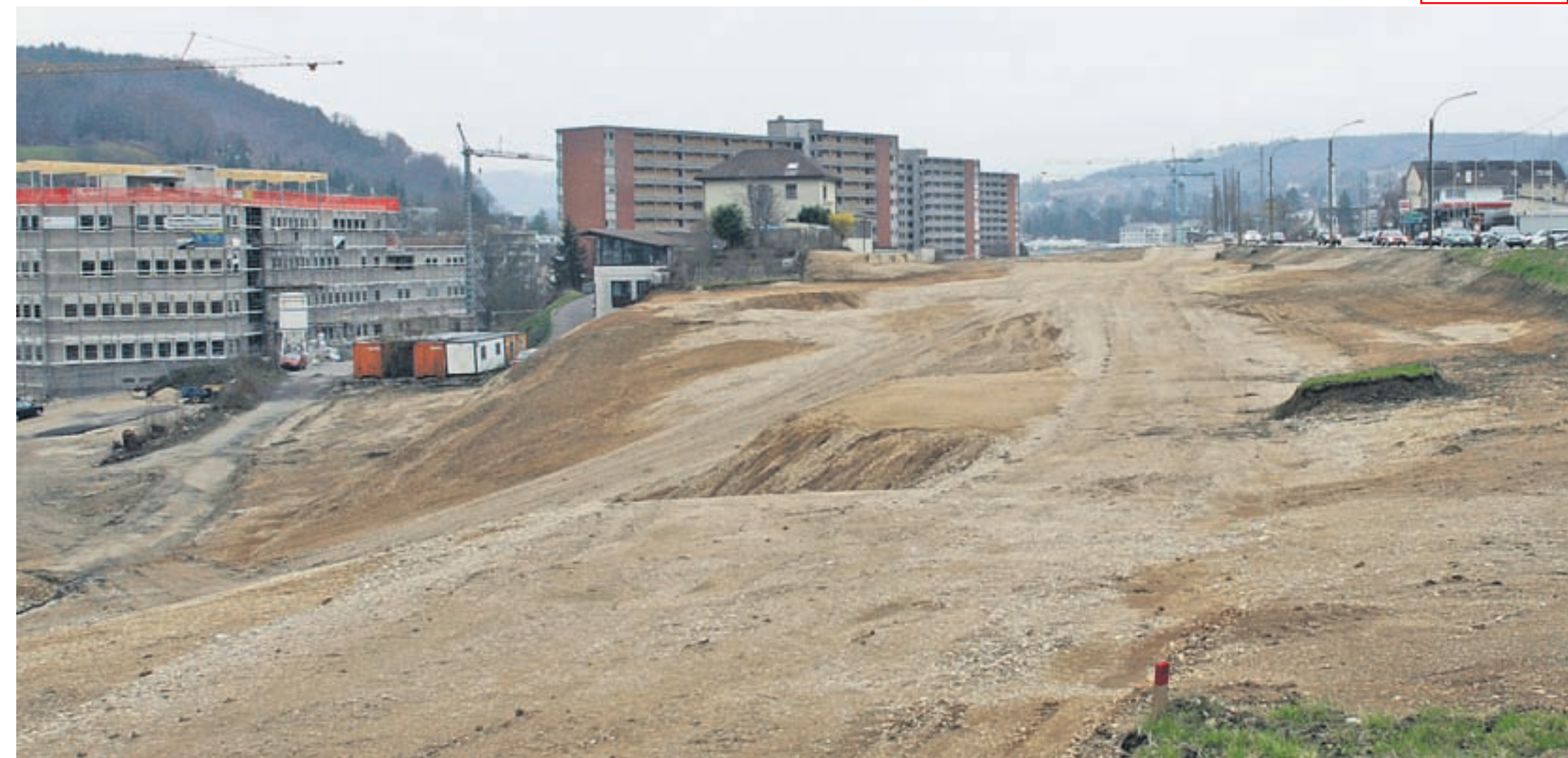
Teure Schnellstrasse. Im Baselbieter Landrat bahnt sich ein Hickhack zwischen Linken und Bürgerlichen um die Finanzierung der H2 an. Bild: Baustelle zwischen Füllinsdorf und Liestal. Foto Henry Muchenberger
