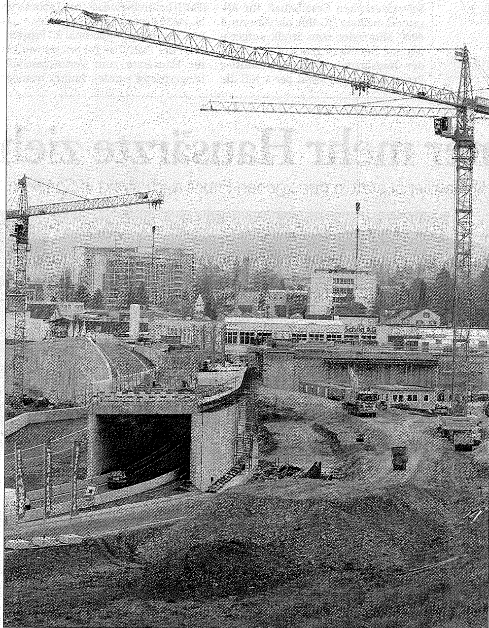
TEURES PFLASTER Der geplante Kostenrahmen für die H2 wird massiv überschritten. JURI JUNKOV
